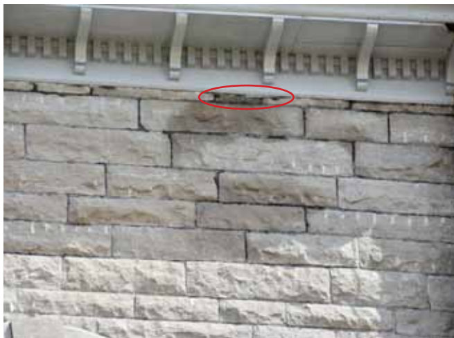
Figure 70 : Des traces d'humidité sur les pierres au sommet de la façade latérale ouest témoignent d'infiltrations d'eau à travers le soffite.
