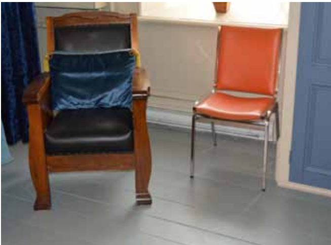
Figure 144 : Le plancher du sous-sol de la sacristie est constitué d'un parquet de bois peint en gris. Le bois et la peinture sont encore en bon état.
