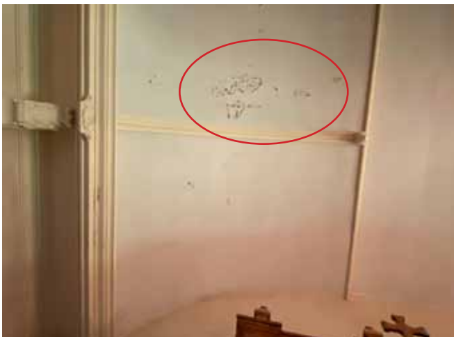
Figure 147 : D'importantes sections de peinture commencent également à écailler.
