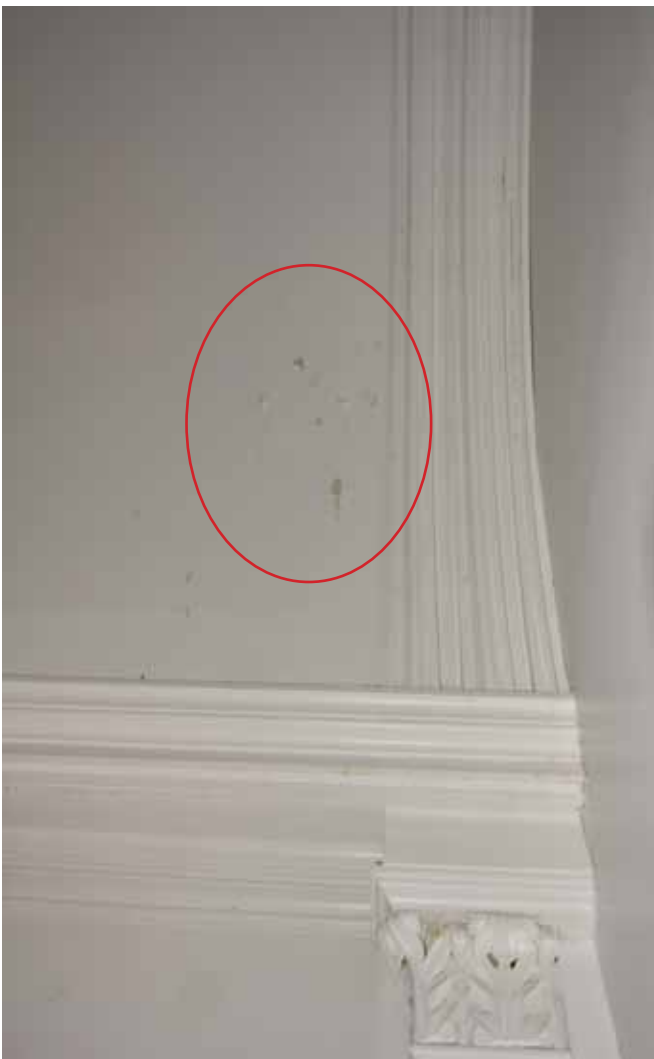
Figure 148 : D'importantes sections de peinture commencent également à écailler.
