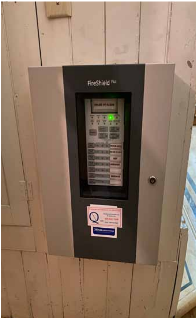
Figure 173 : L'église est munie d'un système de détection et d'alarme-incendie. Le système est raccordé à une centrale.
