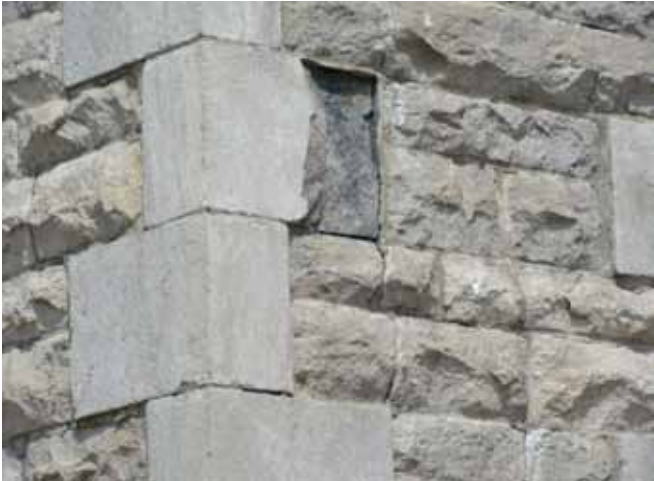
Figure 69 : Au coin sud-ouest de la façade principale, une des pierres constituant la chaîne d'angle présente une épaufrure importante.
