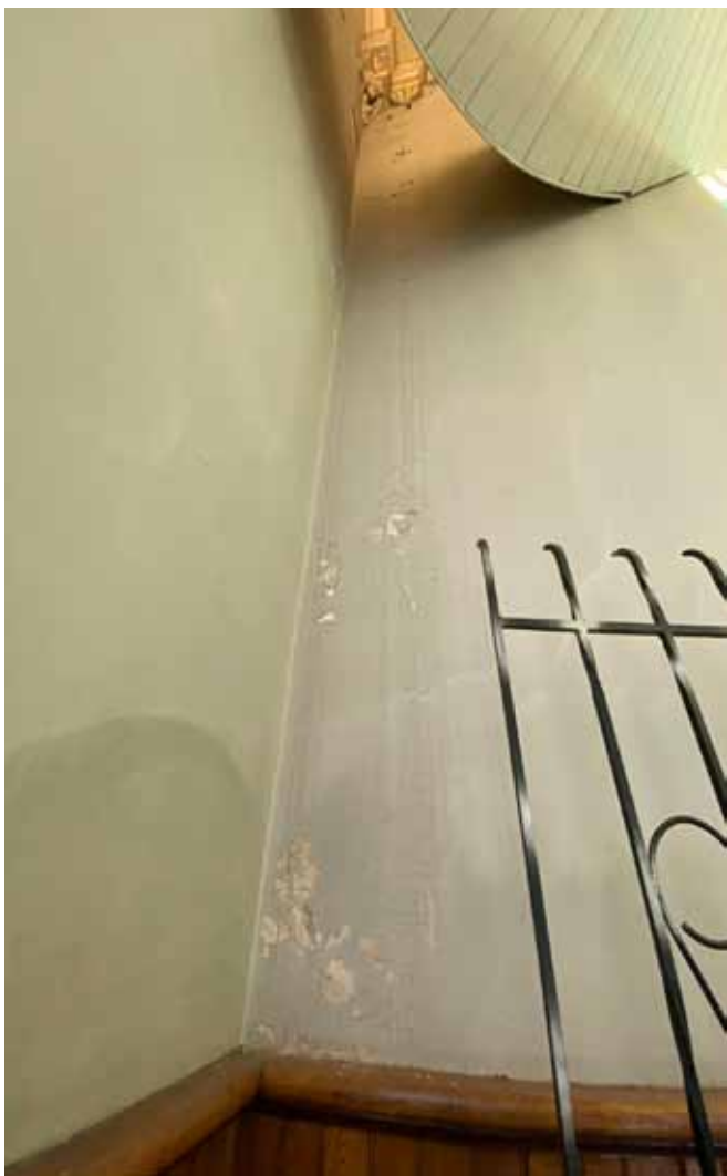
Figure 132 : À l'arrière de l'église, la peinture s'écaille de façon importante et le plâtre s'effrite de façon très importante vis-à-vis la porte du côté ouest.
