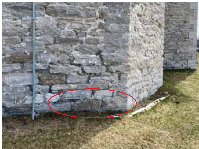
Figure 24 : Les éclaboussures de terre sur les murs lors des précipitations font en sorte que la base des murs demeure plus humide.
