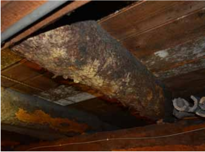
Figure 38 : Malgré la faible humidité au sous-sol, certaines grumes présentent des traces de moisissures jaunes.
