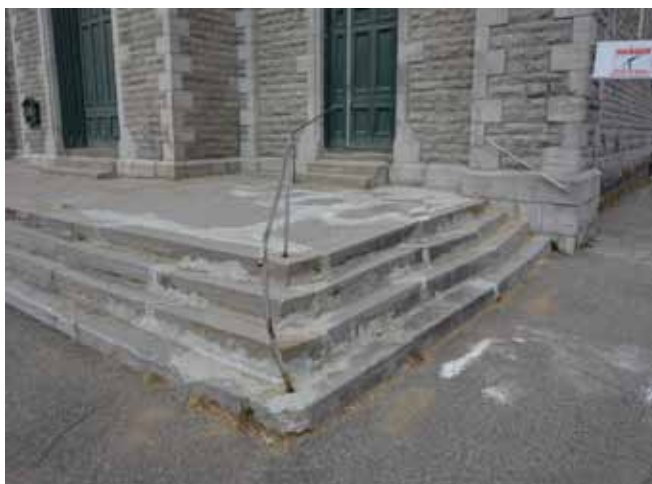
Figure 26 : Il est très dégradé. Il présente plusieurs fissures importantes et certaines bordures des marches sont très abimées.
