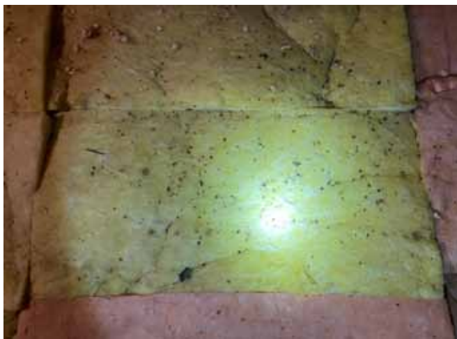
Figure 102 : Des traces de la présence de ces animaux sont d'ailleurs visibles sur l'isolant.
