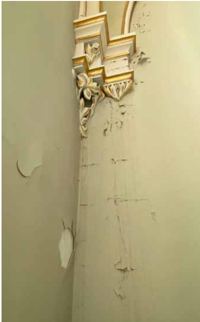
Figure 133 : À l'arrière de l'église, la peinture s'écaille de façon importante et le plâtre s'effrite de façon très importante vis-à-vis la porte du côté ouest.
