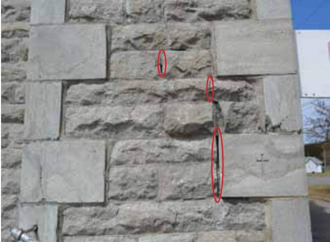
Figure 65 : Plusieurs joints ont également été réparés avec du mortier à base de ciment et plusieurs joints sont fissurés, voire évidés.
