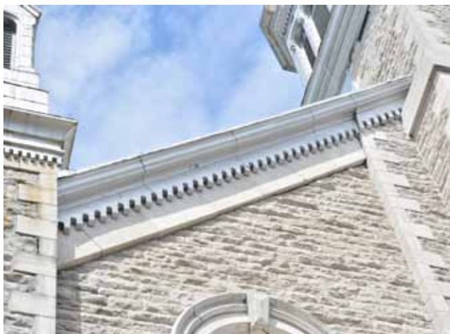
Figure 80 : La façade principale est couronnée par une corniche moulurée ornée de denticules, le tout recouvert de tôle, de part et d'autre du clocher. Ces deux corniches sont en bon état.
