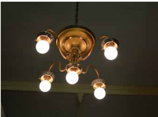
Figure 170 : Des luminaires suspendus d'aspect ancien en laiton sont conservés dans la sacristie.
