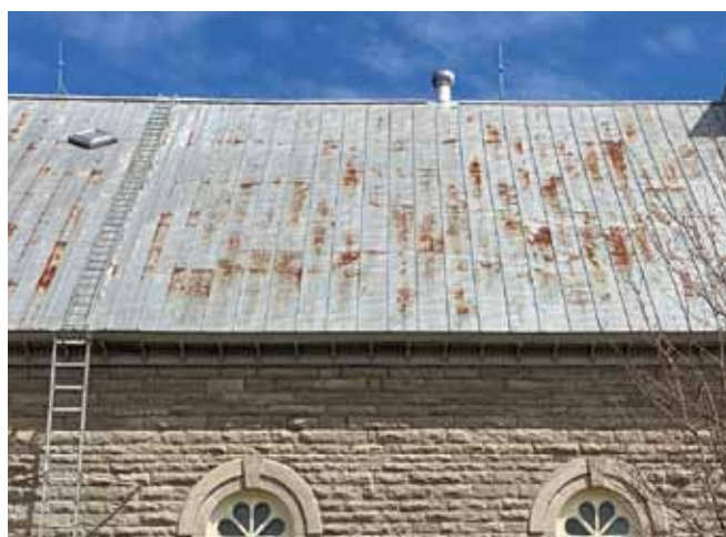
Figure 95 : Le revêtement de toiture de la nef est constitué de tôle à joints debout. La tôle est largement rouillée sur les deux versants.
