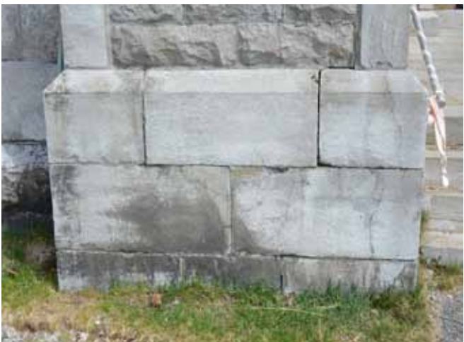
Figure 13 : À l'extérieur, la partie visible des fondations à la base des murs est constituée de blocs de pierre taillée. Plusieurs joints sont creux ou évidés, ce qui peut entraîner des infiltrations d'eau.
