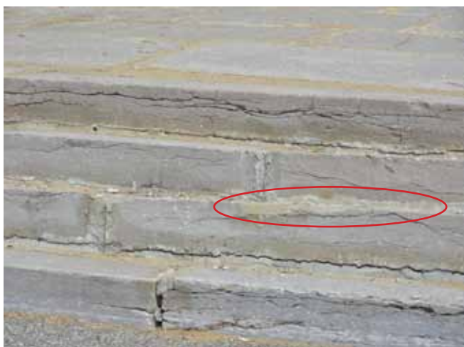
Figure 28 : Il est très dégradé. Il présente plusieurs fissures importantes et certaines bordures des marches sont très abimées.
