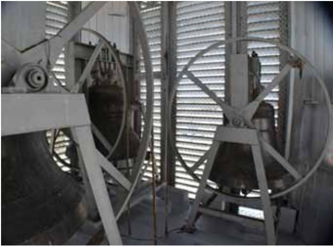
Figure 183 : Les cloches sont montées sur des tréteaux métalliques en bon état.
