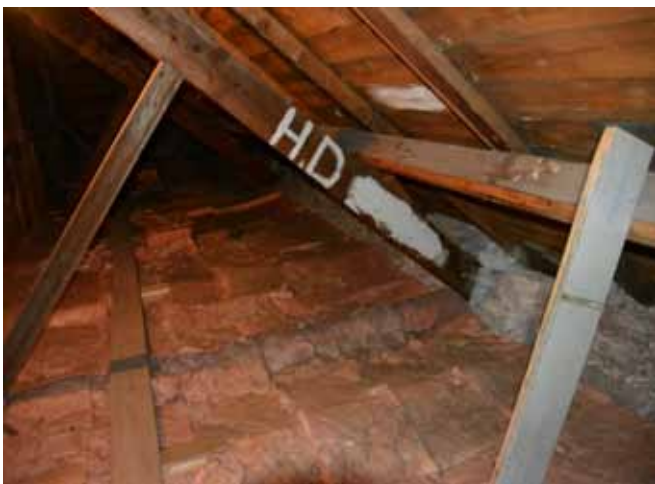
Figure 100 : Le plafond de la voûte et les planchers de l'entretait ont été recouverts d'isolant en nattes de fibre de verre. L'isolant est généralement dégradé, voire souillé par les infiltrations d'eau.
