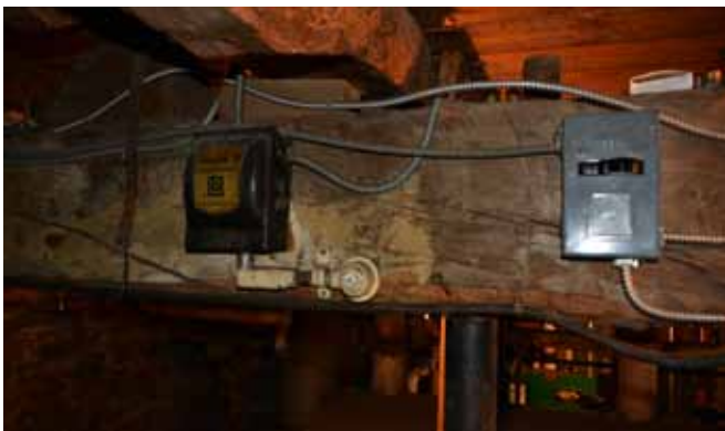
Figure 168 : D'anciens sectionneurs sont toujours présents. Ils servaient probablement à isoler le circuit électrique alimentant les équipements d'appoints de la chaudière à huile (pompe, brûleur).
