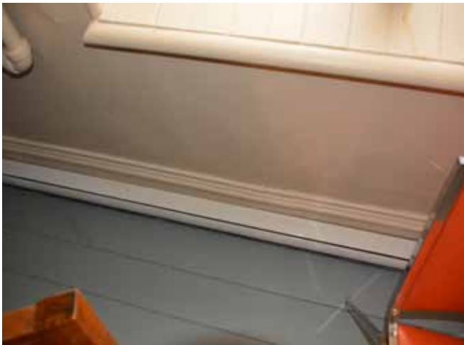
Figure 135 : Les murs intérieurs de la nef sont en plâtre peint. La finition intérieure des murs présente des fissures mineures.
