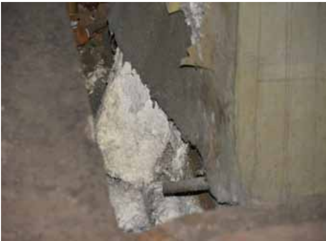
Figure 162 : Il y a possiblement de l'amiante autour de la chaudière.
