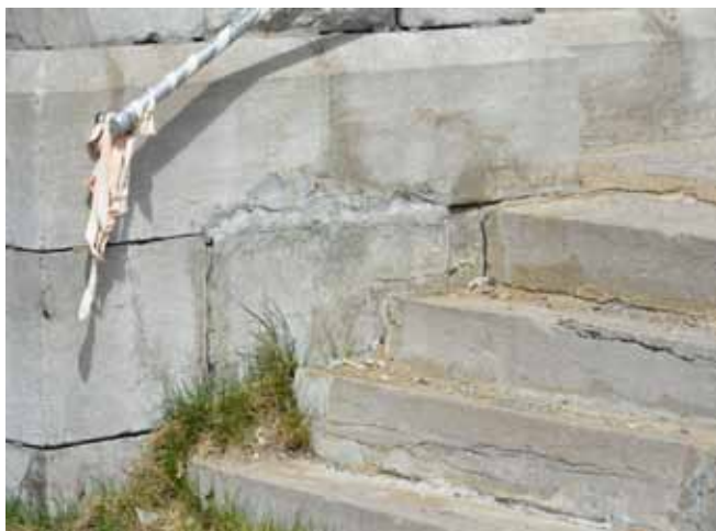
Figure 30 : La jonction du parvis et de la base des murs est un endroit propice aux infiltrations d'eau. L'affaissement des marches contribue à retenir l'eau, qui peut ensuite s'infiltrer à travers les joints dégradés de la maçonnerie. De l'herbe pousse d'ailleurs entre les pierres du parvis et à la base des murs de l'église, notamment au coin sud-ouest.
