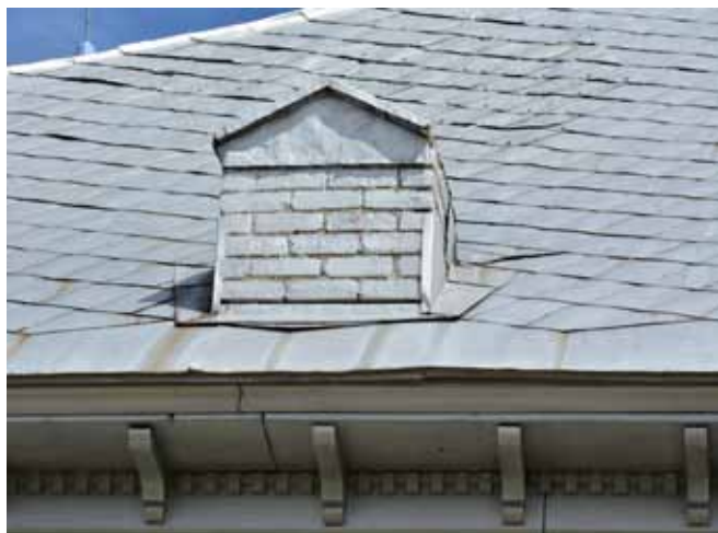
Figure 104 : Une ancienne cheminée de la sacristie a été étêtée et recouverte de tôle, ce qui lui donne l'aspect d'une lucarne.
