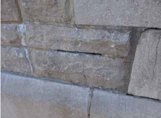
Figure 66 : Plusieurs joints ont également été réparés avec du mortier à base de ciment et plusieurs joints sont fissurés, voire évidés.
