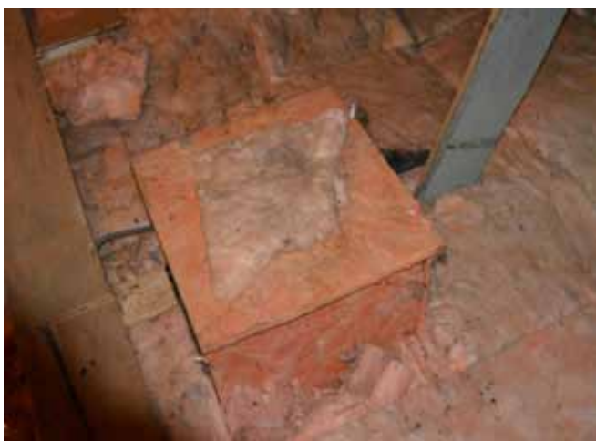
Figure 99 : Le plafond de la voûte et les planchers de l'entretait ont été recouverts d'isolant en nattes de fibre de verre. L'isolant est généralement dégradé, voire souillé par les infiltrations d'eau.
