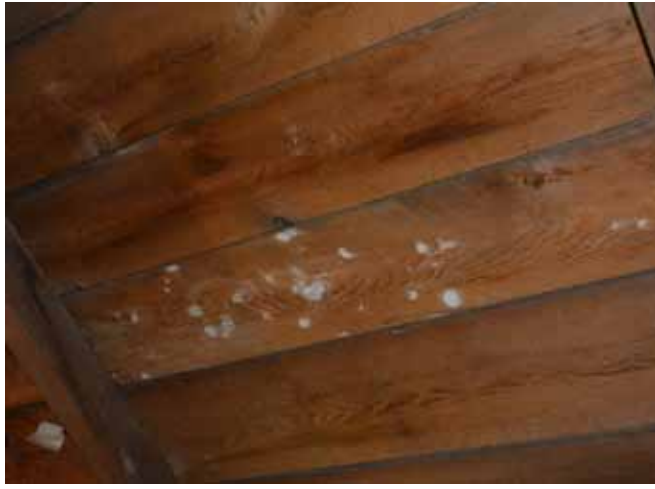
Figure 51 : Là où il y a des infiltrations d'eau depuis longtemps, la structure est attaquée par la moisissure et la pourriture, et ce, depuis plusieurs années.
