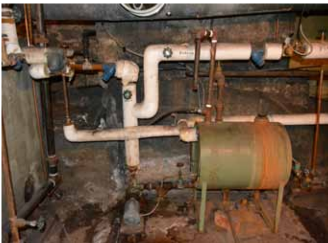
Figure 165 : Les canalisations sont isolées et l'isolant est récent et en bon état.
