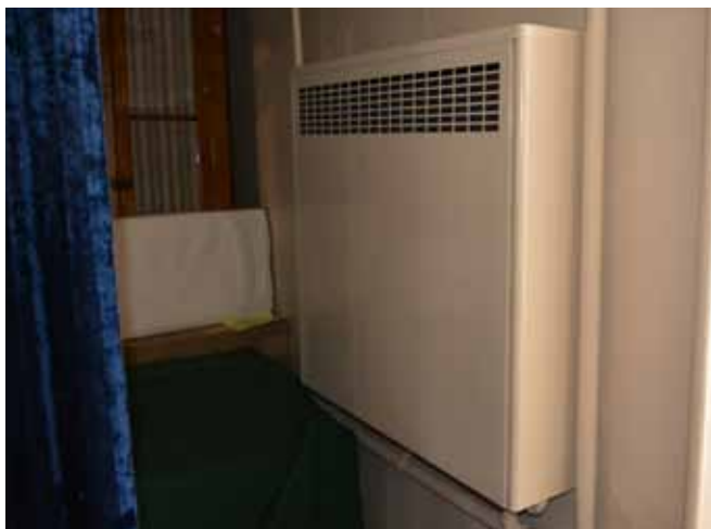
Figure 164 : La vapeur est distribuée dans des calorifères à ailettes.
