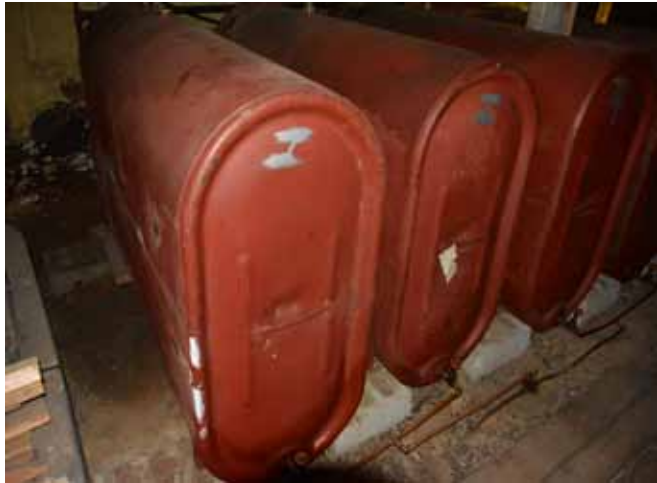
Figure 159 : Le mazout était stocké dans des réservoirs situés au sous-sol.
