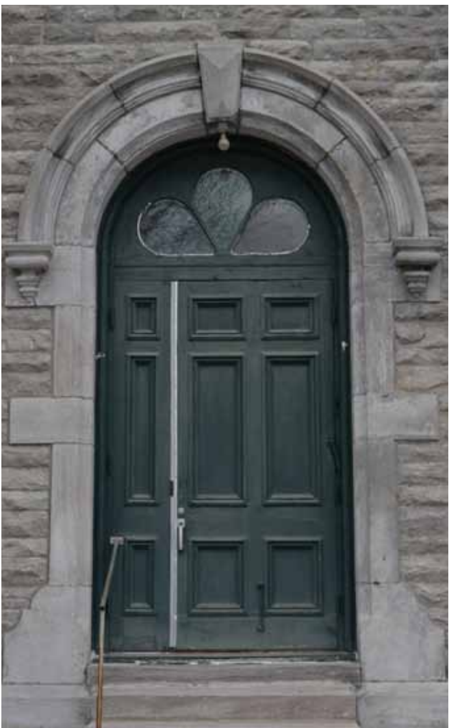
Figure 90 : Les portes latérales possèdent une porte à battant et un vantail plus étroit. La porte du côté droit a été munie d'une quincaillerie contemporaine et d'un coupe-froid érieur peu élégant.
