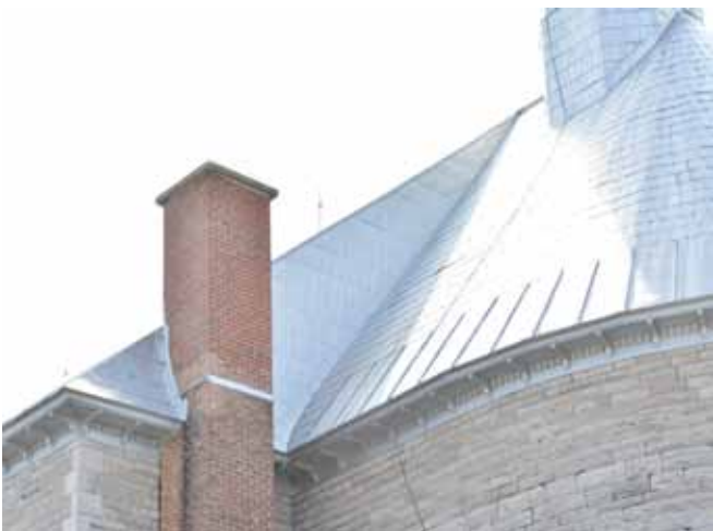
Figure 103 : Une cheminée en brique est située le long du mur arrière de la nef à la jonction du chœur. Plusieurs briques ont été remplacées récemment. Une ceinture de métal fixée à la toiture la maintient.
