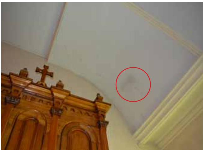
Figure 146 : Des traces témoignent d'infiltrations d'eau depuis la toiture.
