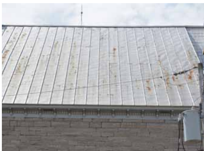
Figure 94 : Le revêtement de toiture de la nef est constitué de tôle à joints debout. La tôle est largement rouillée sur les deux versants.
