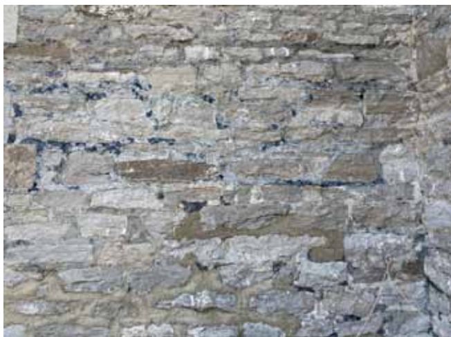
Figure 71 : Le mur arrière de la sacristie est constitué de moellons ébauchés. La maçonnerie a été recouverte d'un enduit qui est aujourd'hui très dégradé. Elle a également été rejointoyée avec du mortier cimentaire.
