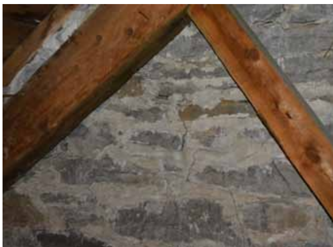
Figure 72 : Des joints dégradés et fissurés sont aussi à déplorer sur la paroi intérieure de la maçonnerie des murs des pignons.
