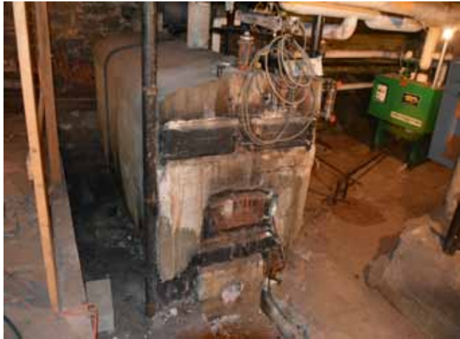
Figure 161 : L'ancienne chaudière au charbon a été transformée pour fonctionner à l'huile.
