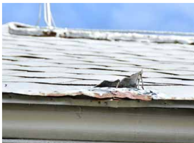
Figure 97 : Plusieurs tôles sont également très gondolées. Du côté est, une tôle s'est soulevée, ce qui permet de constater que celle-ci a été clouée, possiblement après l'apparition de premières déformations.
