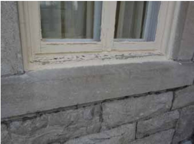
Figure 87 : La peinture des contre-fenêtres est écaillée.
