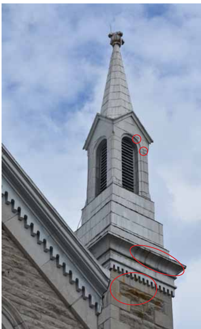
Figure 62 : La façade est ornée de pinacles en tôle situés de chaque côté du clocher. Des coulisses sur la tôle et la pierre suggèrent que la tôle a été vissée et que certaines vis sont rouillées.
