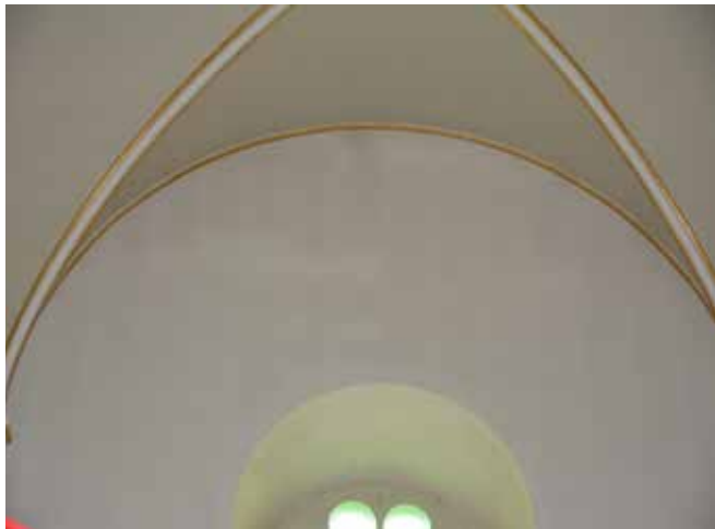
Figure 131 : Des traces noires sont visibles sur la rinition intérieure des murs extérieurs, surtout au sommet des fenêtres.
