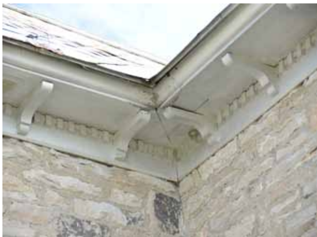
Figure 77 : Les larmiers sont en mauvais état et nécessitent d'être restaurés. La peinture commence à s'écailer. Le bois est déformé et présente des traces de moisissures.
