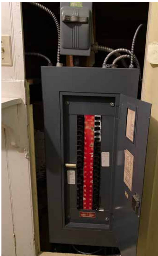
Figure 166 : Le panneau électrique de l'église est situé au rez-de-chaussée de la sacristie.
