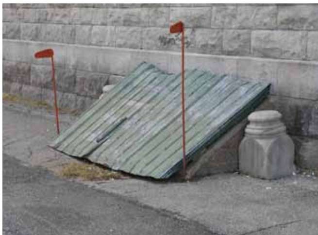
Figure 92 : Une ancienne entrée de cave délimitée par deux murets en béton et protégée par une trappe recouverte de tôle est présente à la base de la façade est vers le milieu de la nef.
