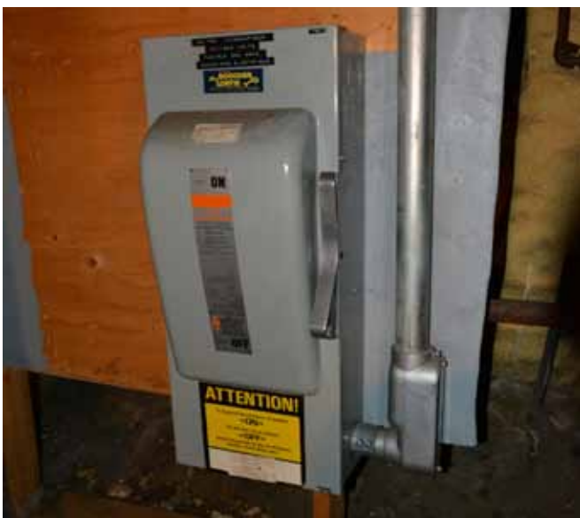
Figure 167 : La chaudière électrique possède un interrupteur sectionneur 600 V et 200 A monté sur contreplaqué. Il s'agit d'une installation récente
