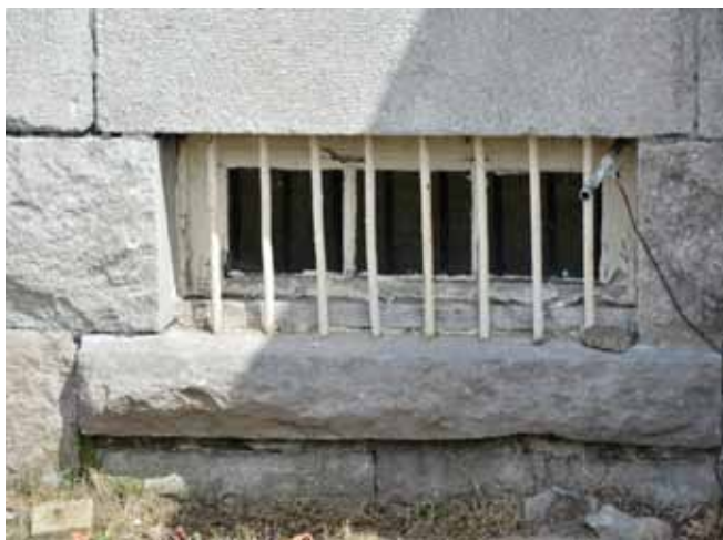
Figure 73 : Les fenêtres du sous-sol sont munies de grillage de sécurité.
