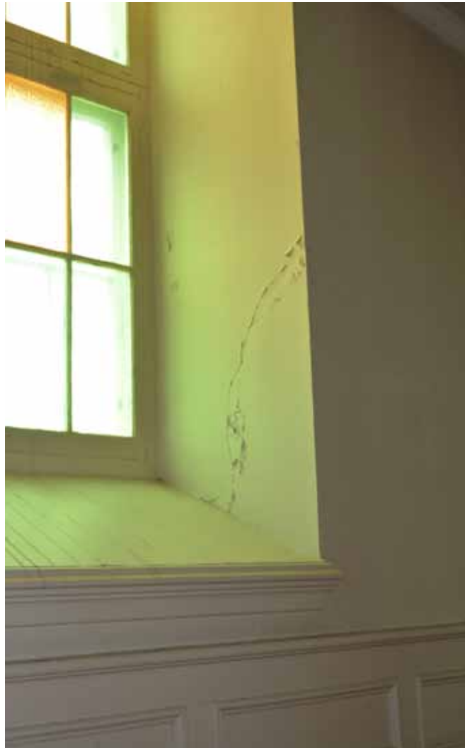
Figure 134 : Des fissures sont aussi visibles sur les joues des fenêtres.
