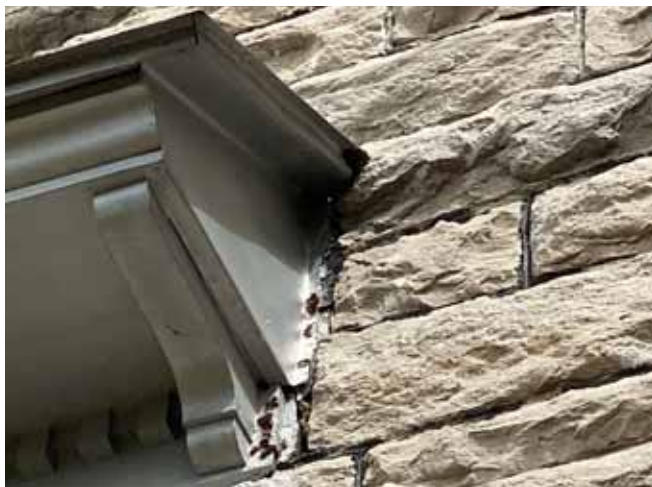
Figure 79 : La tôle qui recouvre le retour de larmier de la sacristie du côté ouest, vis-à-vis le chœur, est très dégradée et l'étanchéité de ce joint n'est plus assurée.
