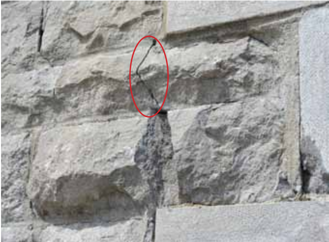
Figure 68 : Plusieurs pierres sont fissurées.
