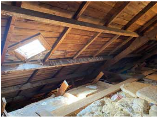
Figure 50 : Des cernes sur certaines planches du platelage de la charpente témoignent d'infiltrations d'eau.
