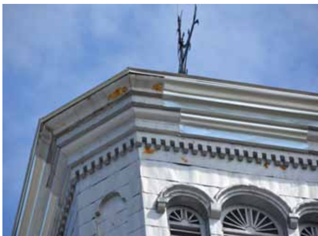
Figure 74 : La lanterne du clocher est couronnée par une large corniche moulurée recouverte de tôle. La tôle est largement rouillée et des sections importantes ont été recouvertes de nouvelle tôle vissée.
