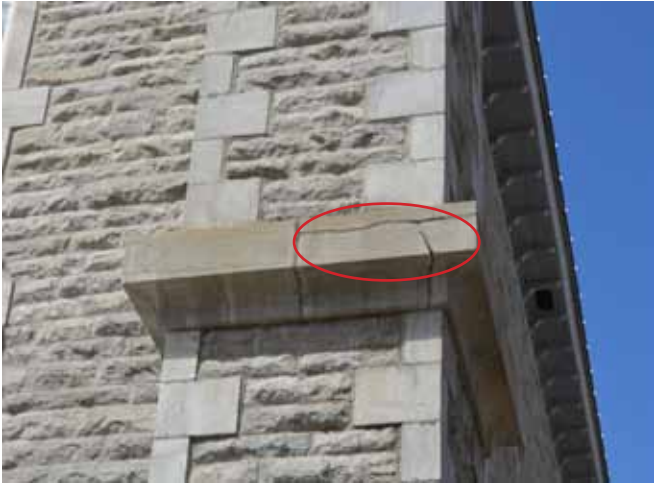
Figure 64 : Les chaînes d'angle sont constituées de pierre avec un fini bouchardé fin, tandis que le reste de la maçonnerie présente un bossage rustique. Plusieurs pierres sont fissurées.
