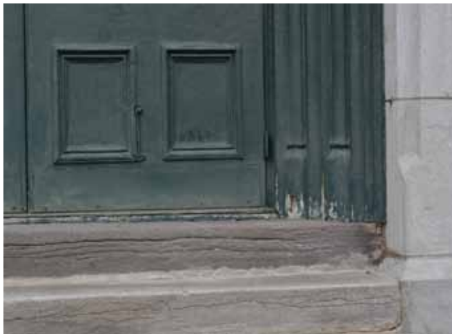
Figure 91 : Depuis, la peinture a perdu un peu de son lustre et est écaillée surtout dans le bas des portes, laissant le bois à nu.
