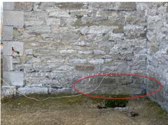
Figure 23 : Les éclaboussures de terre sur les murs lors des précipitations font en sorte que la base des murs demeure plus humide.
