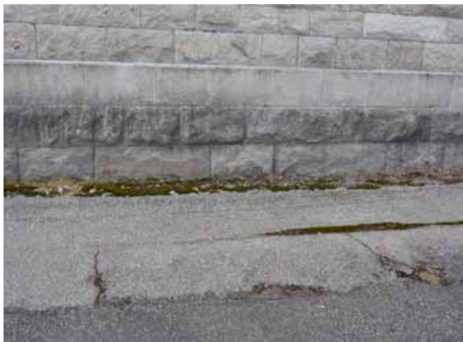
Figure 12 : À l'extérieur, la partie visible des fondations à la base des murs est constituée de blocs de pierre taillée. Plusieurs joints sont creux ou évidés, ce qui peut entraîner des infiltrations d'eau.
