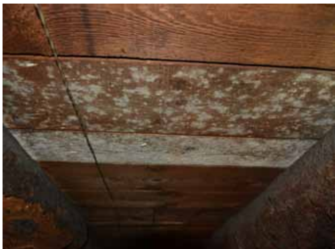
Figure 39 : Des traces de moisissures blanches sont aussi visibles sous certaines planches du platelage.
