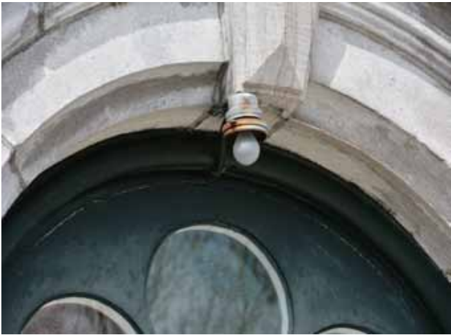
Figure 172 : Le globe du luminaire au-dessus de la porte du côté gauche est cassé.
