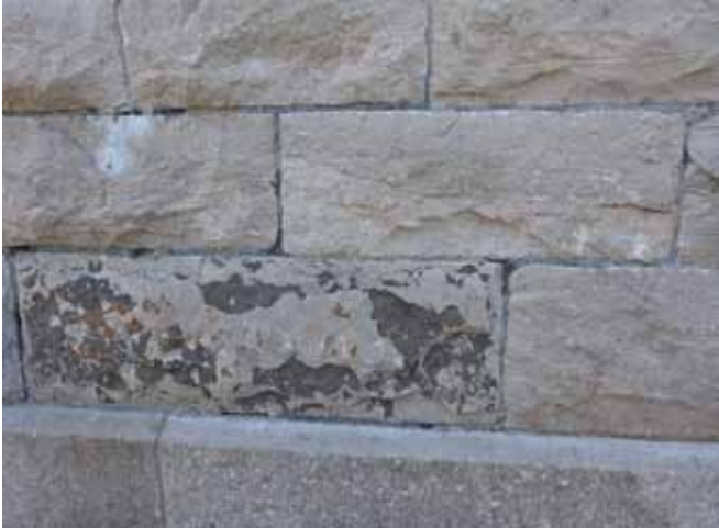
Figure 67 : La maçonnerie a été rejointoyée en 1960 avec un mortier noir qui est encore visible par endroits.
