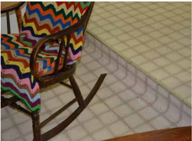
Figure 121 : Le plancher de la sacristie présente une différence de hauteur de quelques pouces.
