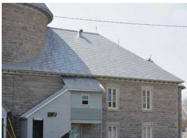
Figure 96 : Sur le versant est, des coulisses de rouille témoignent que la tôle a été clouée et que les clous ont commencé à rouiller.
