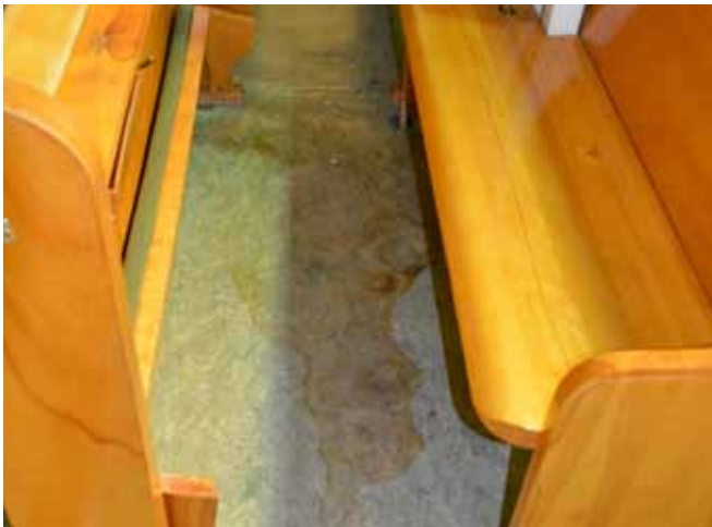
Figure 142 : Sur la galerie arrière, des infiltrations d'eau vis-à-vis du clocher ont dégradé certaines tuiles.
