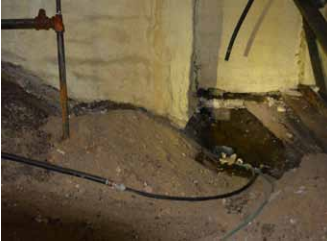
Figure 35 : Une dépression dans le sol vis-à-vis une ancienne ouverture se remplit parfois d'eau. Une pompe est aménagée pour évacuer l'eau.
