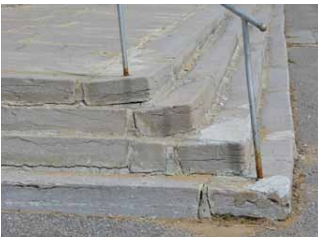
Figure 27 : Il est très dégradé. Il présente plusieurs fissures importantes et certaines bordures des marches sont très abimées.
