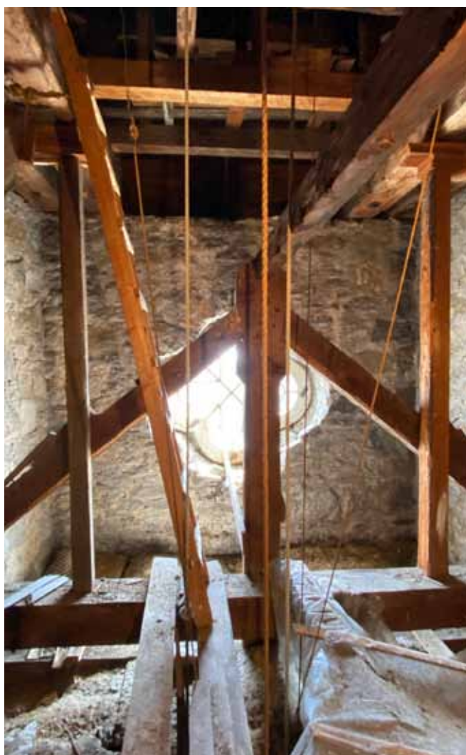
Figure 58 : Néanmoins, la paroi intérieure de la maçonnerie du clocher est généralement en bon état. Des fientes d'oiseau sont également visibles
