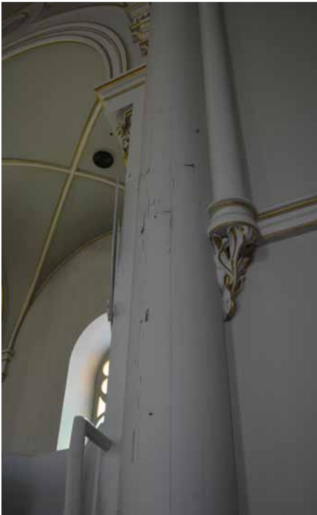
Figure 138 : Les colonnes de l'église sont en bois peint. La peinture est craquelée et commence à s'écailer.
