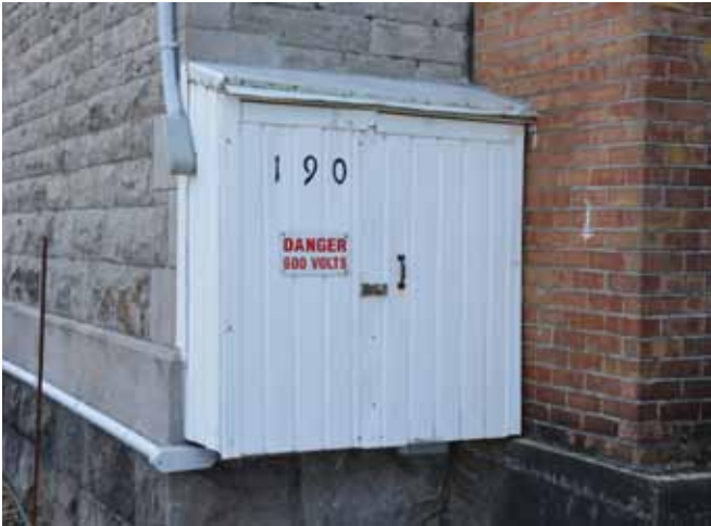
Figure 160 : Une nouvelle entrée électrique de 600 volts protégée à l'extérieur par une armoire de bois constituée de planches de bois peintes en blanc a été aménagée pour faire fonctionner ce système.
