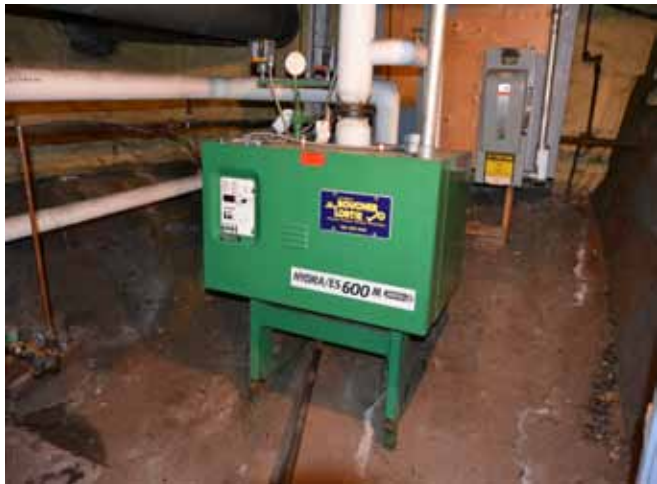
Figure 163 : Elle a été remplacée récemment par une nouvelle chaudière alimentée par la biénergie, c'est-à-dire l'électricité en temps normal et le mazout en période de pointe. Celle-ci ne fonctionne plus qu'à l'électricité dorénavant.
