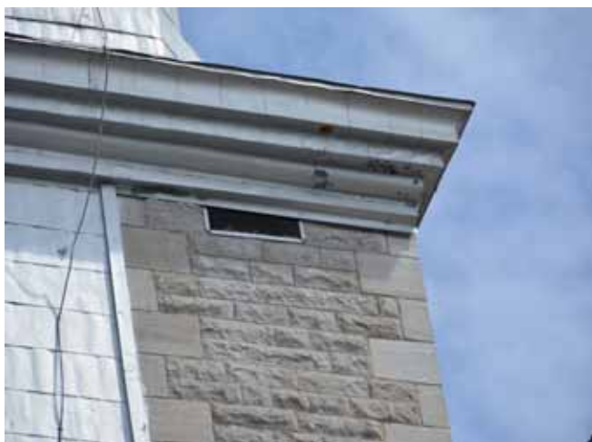
Figure 75 : La base du clocher est également couronnée par une large corniche moulurée recouverte de tôle dont la peinture commence à s'écailer. La base du clocher est ventilée par une grille.
