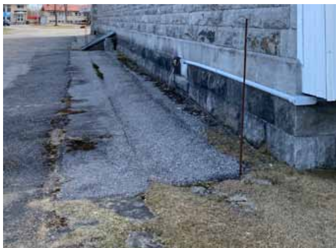
Figure 21 : À l'avant et du côté est, le sol au périmètre de l'église est recouvert d'asphalte. La présence de l'asphalte directement au bas des murs peut poser des problèmes de drainage.
