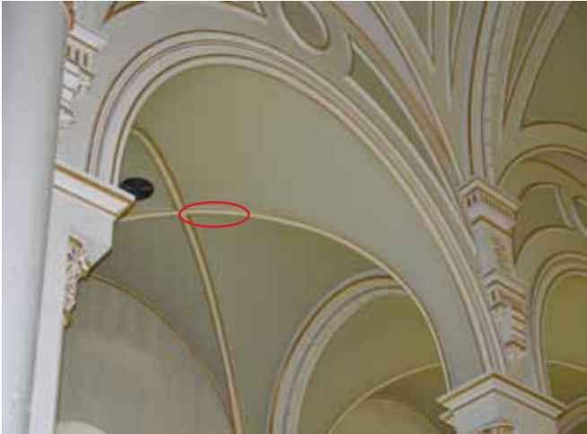
Figure 152 : La peinture de certaines voûtes des nefs latérales commence à s'écailer légèrement.
