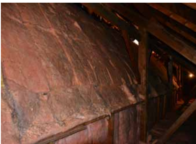
Figure 98 : Le plafond de la voûte et les planchers de l'entretait ont été recouverts d'isolant en nattes de fibre de verre. L'isolant est généralement dégradé, voire souillé par les infiltrations d'eau.
